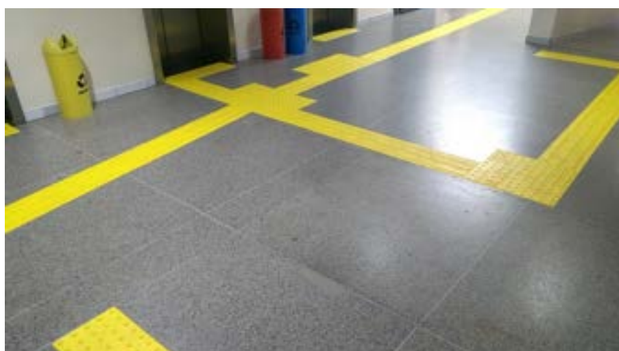
Imagem 07 - Piso tátil instalado no subsolo do edifício-sede do STM
